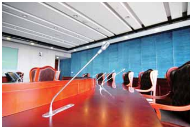
安装于世博中心内部的会议系统产品
